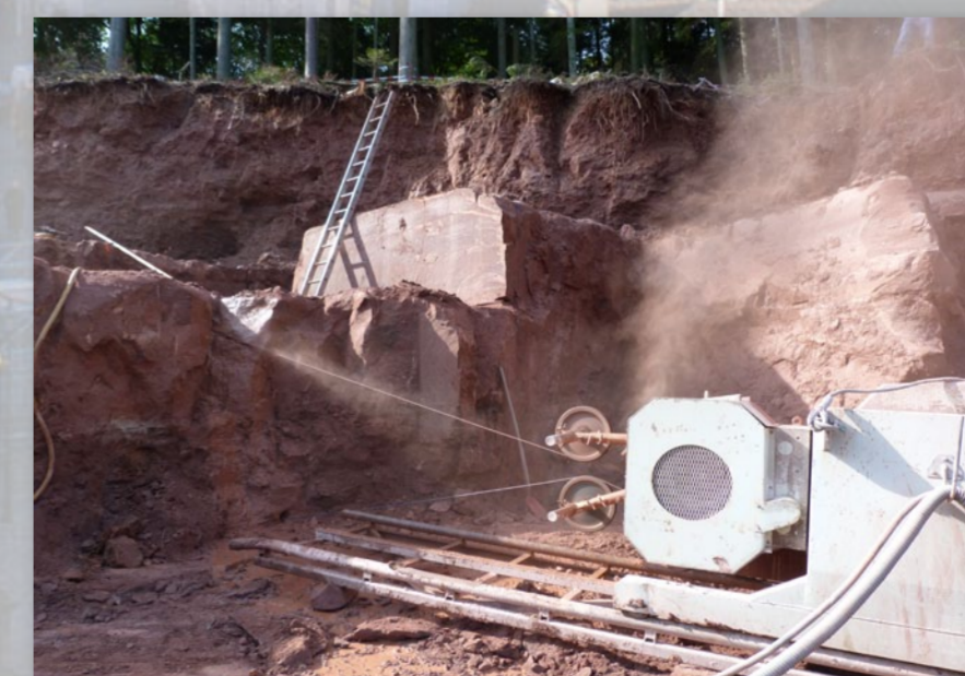
◀ Abb. 12: Als günstigste Methode stellte sich die Kombination von Bohren, Seilsägen und Lösen der Blöcke mit Druckkissen heraus; das Bild zeigt eine Gesteinssäge mit Diamantseil im Einsatz (August 2012). Der Probeabbau wird von der Fa. Lauster Steinbau, Stuttgart, durchgeführt.
