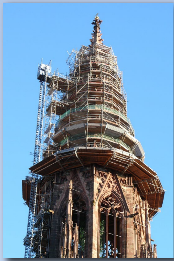
◀ Abb. 2: Die ca. 1300-1340 entstandene, durchbrochene Turmspitze wird seit 2007 aufwändig saniert; das Gerüst wird von der tiefhängenden Oktonhalle getragen, um den filigranen Turmhelm zu schonen.
