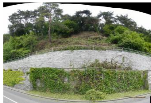
2016 entstandene, sekundäre Rutschung am Radweg bei Sipplingen
