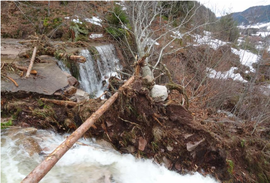
Baufälliges Wehr am Oberen Großbach
