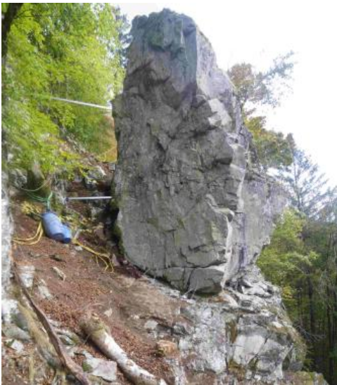
Gefährdungspunkt G031 mit Felsspionen und Extensometern
