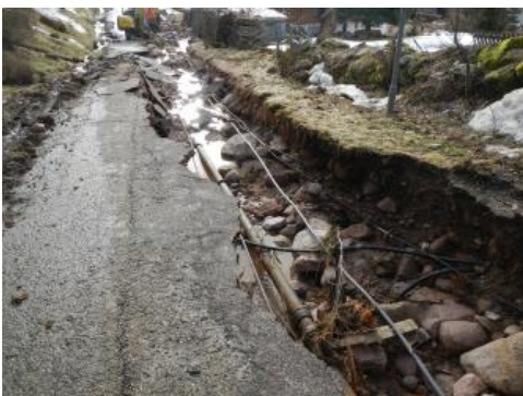
Charakteristische Erosionsschäden am Schwarzenbachweg
