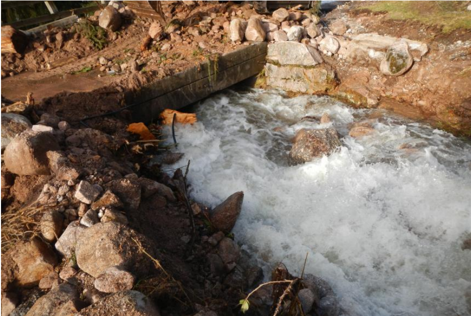
Verklauung der Brücke am Schwarzenbachweg über den stark angeschwollenen Oberen Großbach
