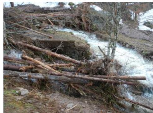
Verkläusung und zerstörte Wirtschaftswegüberfahrt am Oberen Großbach
