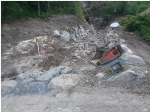
Begradigung des Oberen Großbachs oberhalb der neu angelegten Furt (Foto: Stadt St. Blasien)
