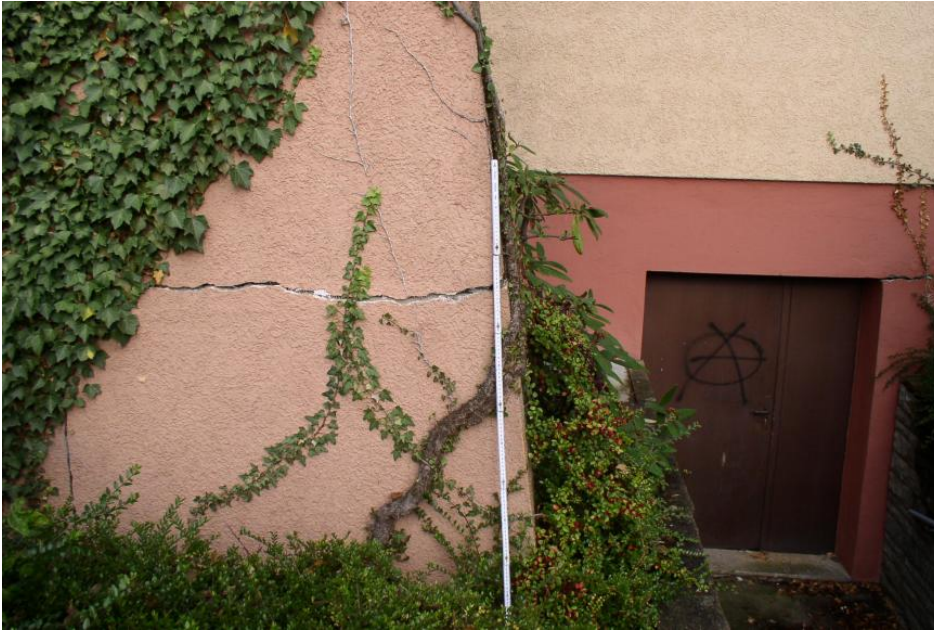
Setzungsrisse an einem Gebäude in Mössingen-Gomaringen
