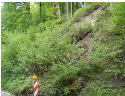
Flachgründige Rutschung an der Kreisstraße K 7769 Lippertsreute–Großschönach
