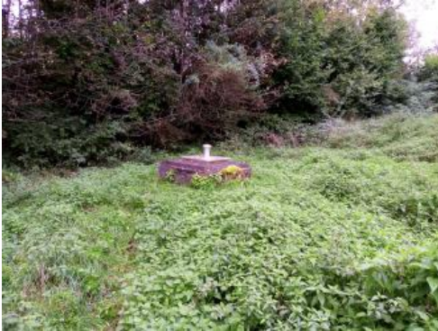
Quellschacht der Jägertalquelle 5, Anselmingen
