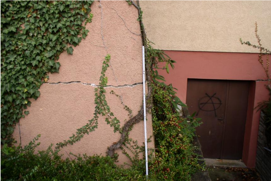
Setzungsrisse an einem Gebäude in Mössingen-Gomaringen
