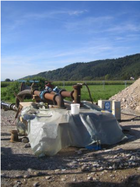
Versuchsaufbau während eines Pumpversuchs zur Bestimmung von Aquiferkennwerten
