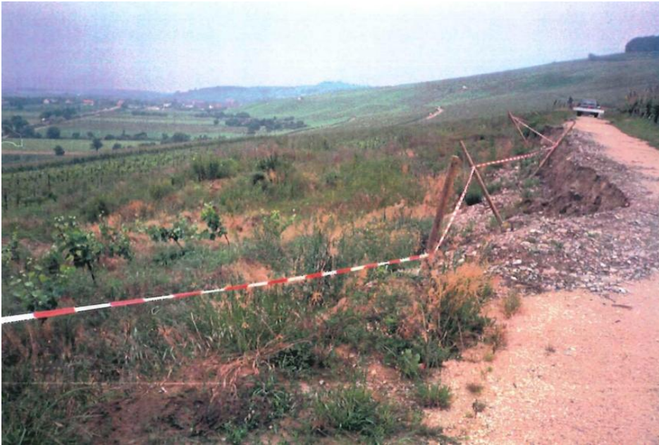
Blick auf eine Rutschung talseits des Wirtschaftsweges im Gewinn „Benz“ (Foto: Ingenieurbüro Ertel & Partner, Müllheim)
