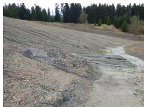
Schräggabbau der stark schluffigen Tonsteine der Obtususton-Formation.
