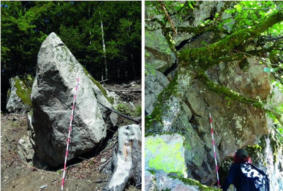
Akut absturzgefährdete Felsblöcke
