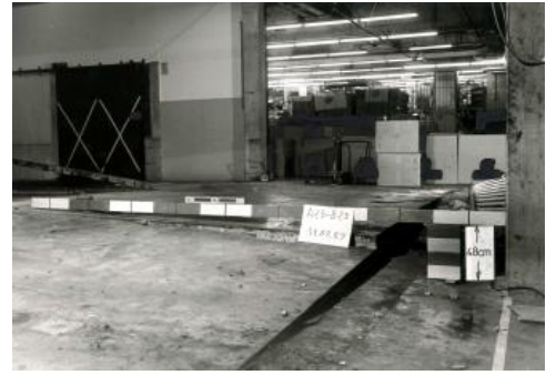
Aufwölbung des Untergrunds
