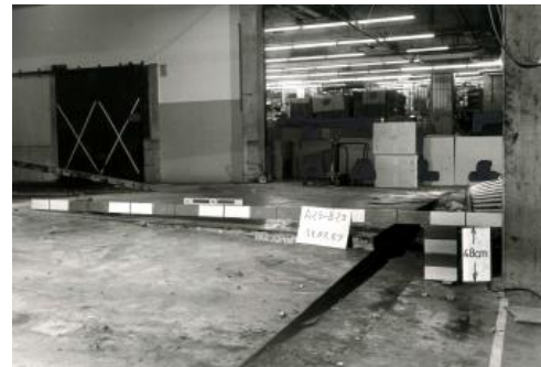
Aufwölbung des Untergrunds
