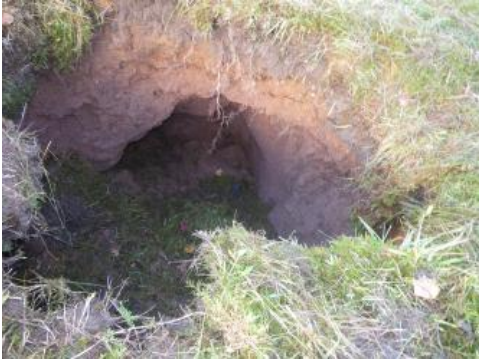
Verbrochene Hohlräumstruktur elliptischer Grundform in quartärem Hangschutt/Fließerde
