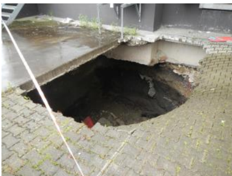
Erdfall bei einem ehemaligen Einkaufsmarkt in Schwenningen vom Mai 2013
