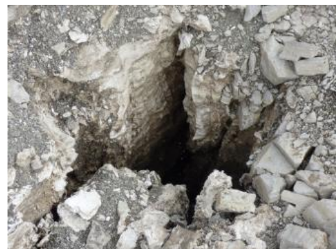
Schlotförmig erweiterte Karstspalte
