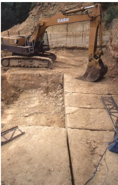
Abbau im Mittleren Lager mittels Schwertsäge und Bagger, Steinbruch O. Meier bei Tengen
