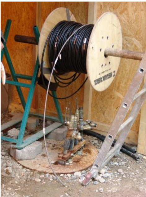
Die Ruhetemperaturprofilmessungen erfolgen u. a. durch stationär in die Erdwärmesonden eingebaute Glasfaserkabel
