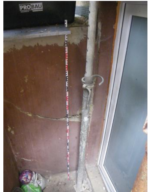
Gebäudeschäden an einem Kellerabgang
