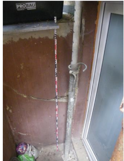
Gebäudeschäden an einem Kellerabgang
