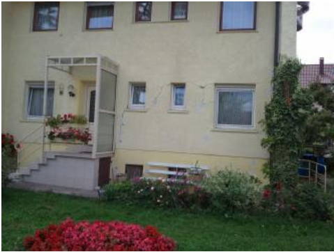
Gebäude mit Setzungsrisse
