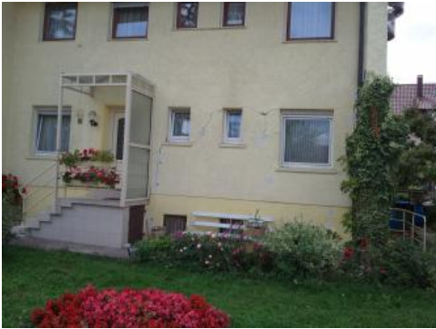
Gebäude mit Setzungsrisse
