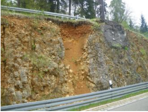
Karstschlotte mit Lehmfüllung im Unteren Massenkalk an der bergseitigen Böschung der K8208
