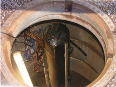
Blick auf den Sondenkopf mit inliegendem Wärmetauscher einer Phasenwechselsonde (Foto: Stober & Bucher, 2014)
