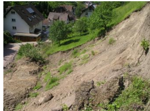
Böschungsbruch an der Schelzbergstraße. Links im Bild ist die provisorische Notfallüberfahrt zu sehen.
