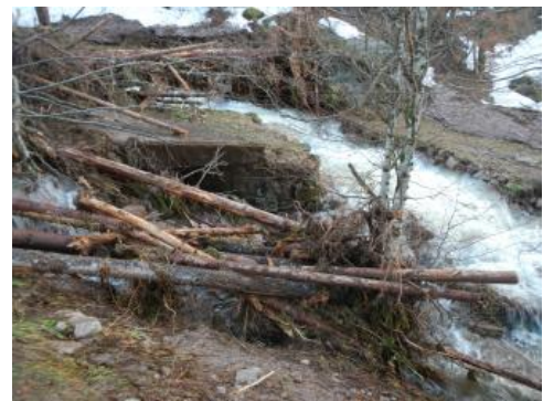
Verklammerung und zerstörte Wirtschaftswegüberfahrt am Oberen Großbach
