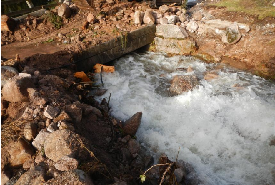
Verklausung der Brücke am Schwarzenbachweg über den stark angeschwollenen Oberen Großbach
