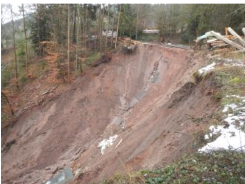
Blick auf den Abrissbereich mit Wasseraustritt durch ein im Hang vorhandenes Rohr. Gegenüberliegend sind an den Abrissbereich angrenzend instabile Bäume zu erkennen.
