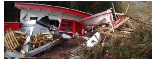
Durch den Murgang vollständig zerstörtes Nebengebäude
