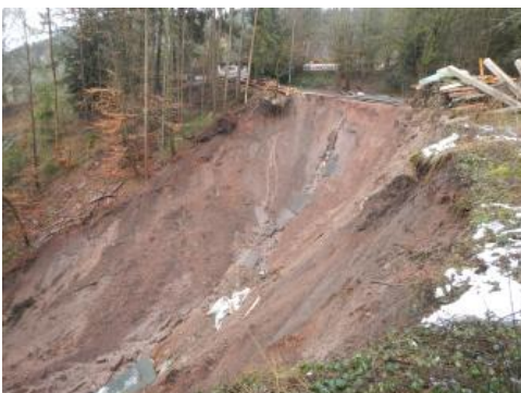
Blick auf den Abrissbereich mit Wasseraustritt durch ein im Hang vorhandenes Rohr. Gegenüberlegend sind an den Abrissbereich angrenzend instabile Bäume zu erkennen.
