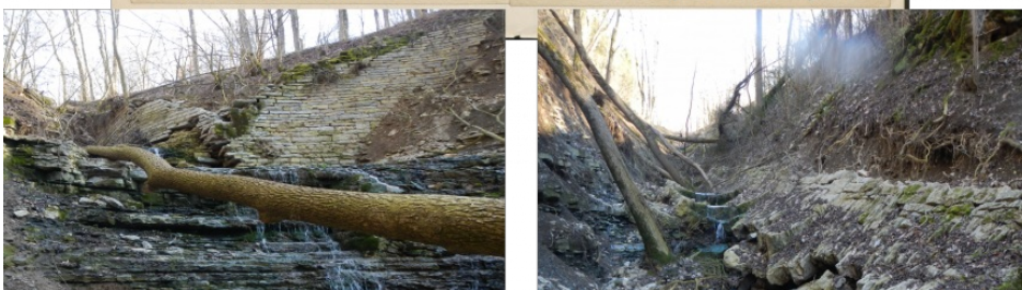
Intakter Tiroler Wildbachverbaue von ca. 1903 im Vergleich zum zerstörten Erscheinungsbild nach dem Ereignis vom 29.05.2019 (Foto: Straßen- und Wasserbauamt, erhalten vom LRA Schwäbisch Hall)
