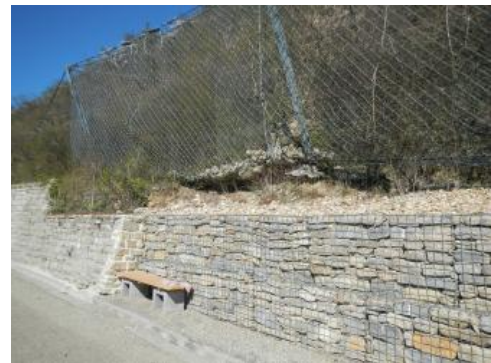
Steinschlagschutzzaun bergseitig des Wurmbergweges (Aufnahme 2014)
