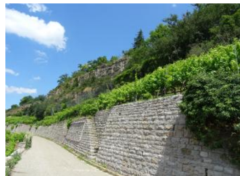
Unterhalb der Hessigheimer Felsengärten verlaufender Steinschlagschutzzaun
