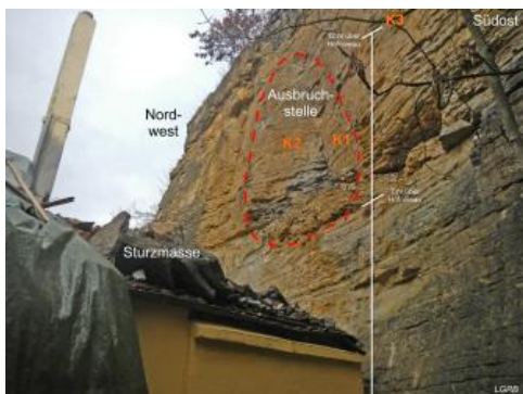
Genaue Lage der Ausbruchsstelle
