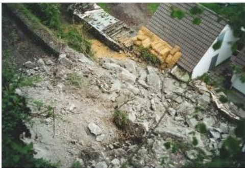
Schadensbild hinter der Wohnbebauung
