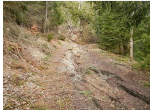
Frische Abrisskante im Forstweg
