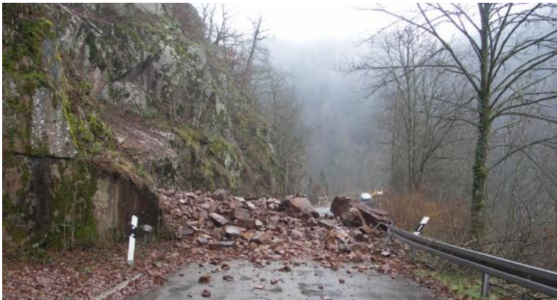
Felssturz an der Kreisstraße K 6561 bei Berau, Lkr. Waldshut
