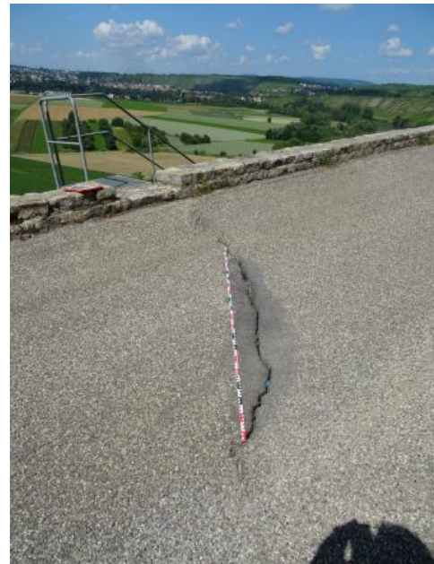
Riss innerhalb des Wurmbergweges (Aufnahme 2020)
