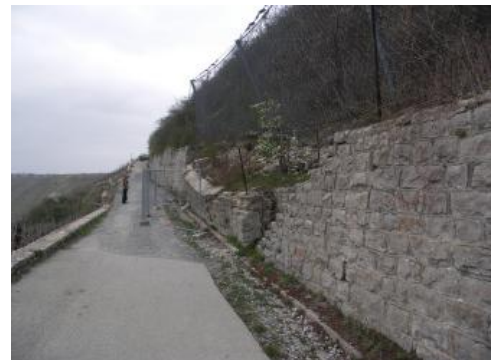
Eingestürzte bergseitige Stützmauer (Aufnahme 2007)
