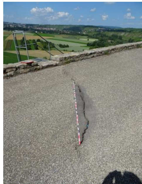
Riss innerhalb des Wurmbergweges (Aufnahme 2020)
