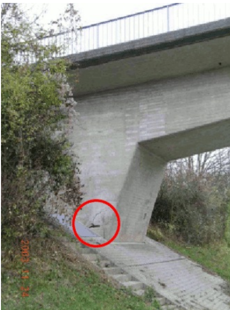
Schäden am Widerlager einer Feldwegüberführung, BW 30/4 (Foto: Brodbeck, 2010)
