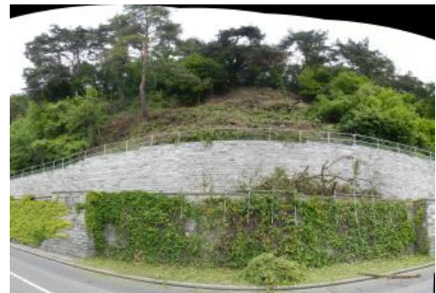
2016 entstandene, sekundäre Rutschung am Radweg bei Sipplingen
