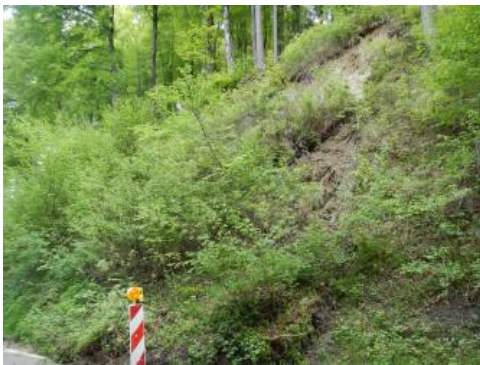
Flachgründige Rutschung an der Kreisstraße K 7769 Lippertsreute–Großschönach
