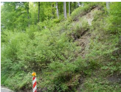
Flachgründige Rutschung an der Kreisstraße K 7769 Lippertsreute–Großschönach
