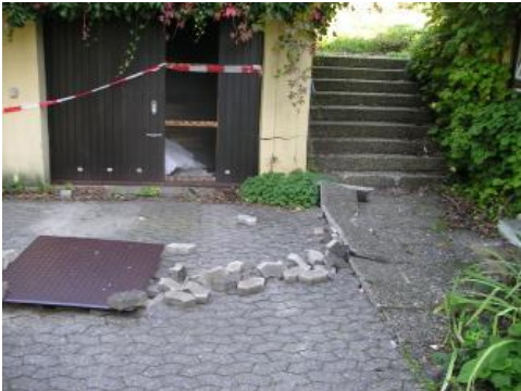
Schubrisse im Mauerwerk und Aufwölbungen im Verbundsteinpflaster
