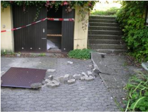
Schubrisse im Mauerwerk und Aufwölbungen im Verbundsteinpflaster
