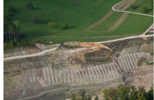
Böschungsrutschung an der Autobahnbaustelle A98.4 bei Minseln
