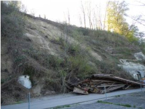
Oberflächennahe Rutschung in Konstanz im Aufwitterungsbereich der Oberen Süßwassermolasse
