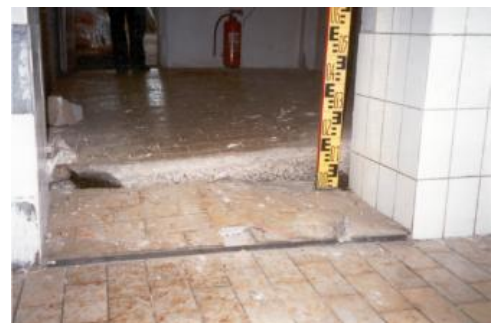
Deformationen eines Hallenbodens durch Hebung
